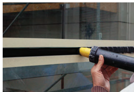
Abb. 2: Handapplikation eines einkomponentigen Silikonklebstoffs für eine tragende Klebverbindung in der aussteifenden Glasfassade der Gedenkstätte Bussmannkapelle Dresden
